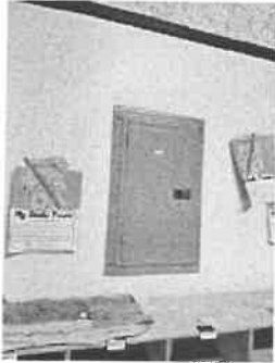
electrical panel 1.jpg 2753K
